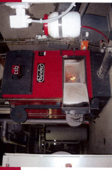
La chaudière fonctionne aux copeaux de bois, elle sert à chauffer l'ensemble du bâtiment.
